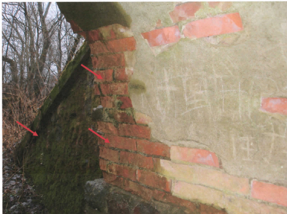
7.att. Slikta ūdens atvades rezultāta bojājumi ķieģeļu velvē. Apudzis mūra atbalstsienas spārniņš (Skats augšteces pusē pie krasta balsta Nr.2 no velves iekšpuses).
