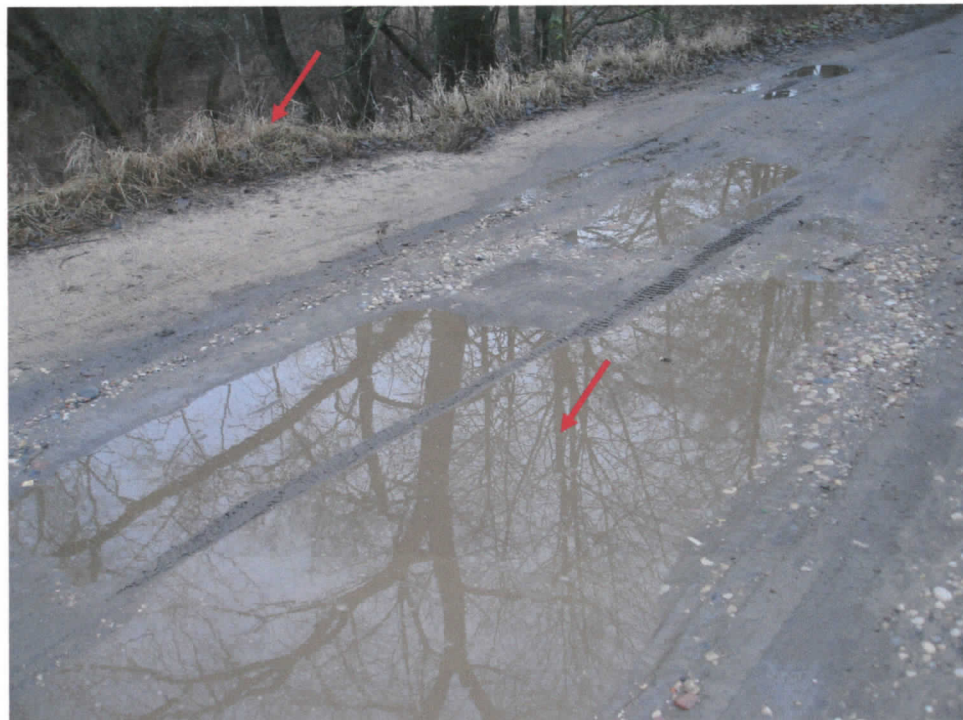
3.att. Grunts segumā uz tilta iebrukta risas, stāv ūdens, pie malām izveidojušies uzaugumi.
