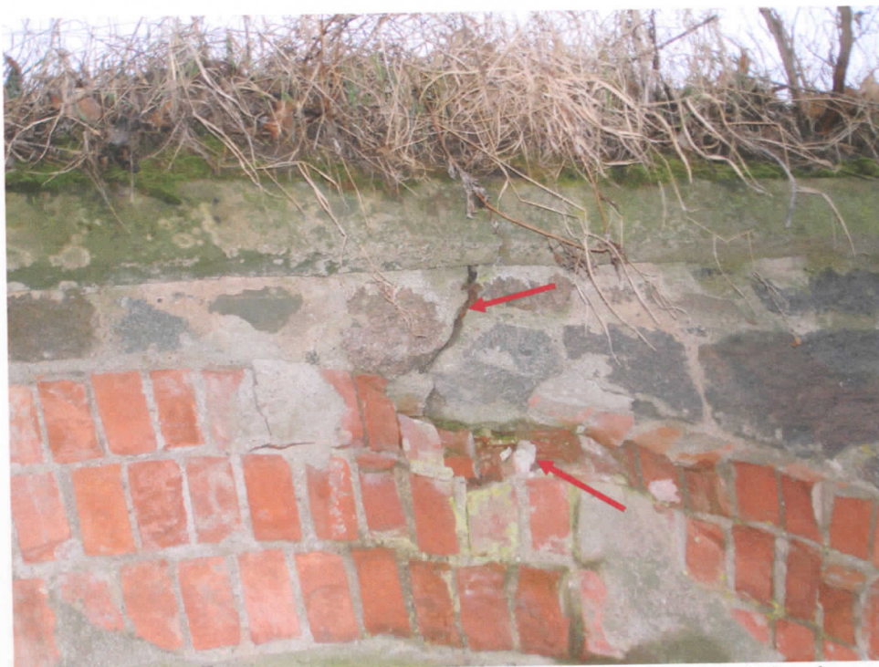
12.att. Ķieģeļu velves un mūra portāla sienas fasādes bojājumi lejteces pusē. Plaša veģetācija. Plīsums mūra portāla sienā.
