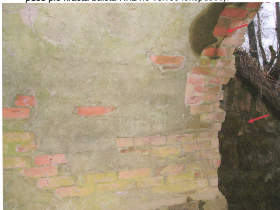
8.att. Slikta ūdens atvades rezultāta bojājumi ķieģeļu velvē. Apudzis mūra atbalstsienas spārniņš (Skats augšteces pusē pie krasta balsta Nr.1 no velves iekšpuses).
