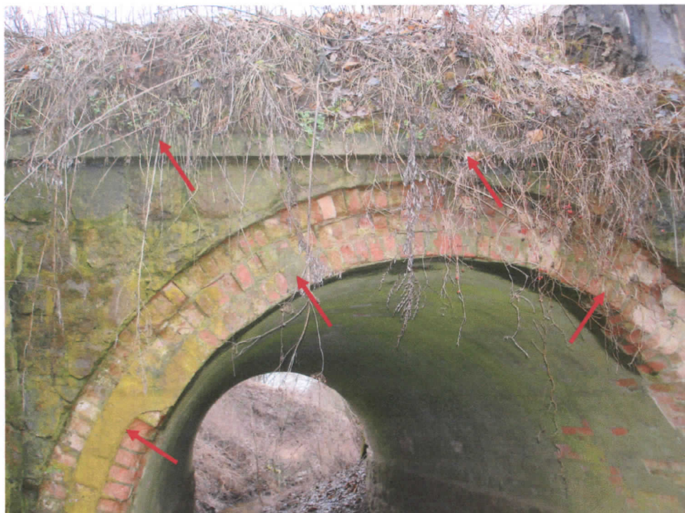
5.att. Ķieģeļu velves un mūra portāla sienas fasādes bojājumi augšteces pusē. Plaša veģetācija.
