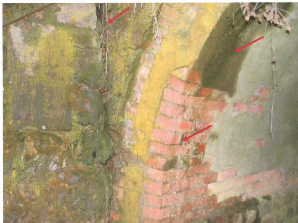
6.att. Slikta ūdens atvades rezultāta bojājumi ķieģeļu velvē. Atdalījusies mūra atbalstsienas spārniņš (Skats augšteces Pusē pie krasta balsta Nr.2).
