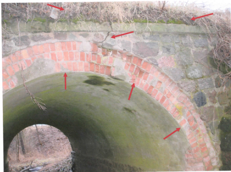
11.att. Ķieģeļu velves un mūra portāla sienas fasādes bojājumi lejteces pusē. Plaša veģetācija. Plīsums mūra portāla sienā.
